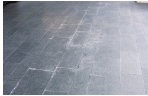
Bei dieser Terrasse weist der Belag einen guten Haftverbund auf. Die starken Ausblühungen werden durch eine fehlerhafte Gefälleausbildung verursacht.
