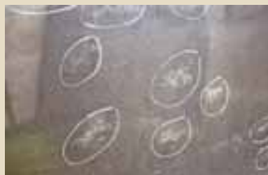
Flecken an vorbehandelter Platte nach Lagerung im Außenbereich
